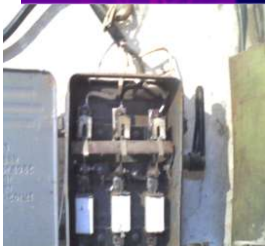
Термограмма 2.1.4.13 Температурное поле электропроводящих частей вводного рубильника скважин №№5275 и 5403
